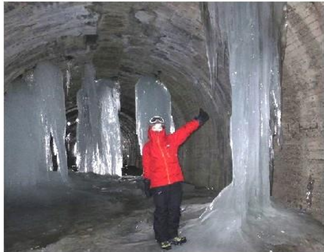
二ツ小屋隧道内の氷柱
