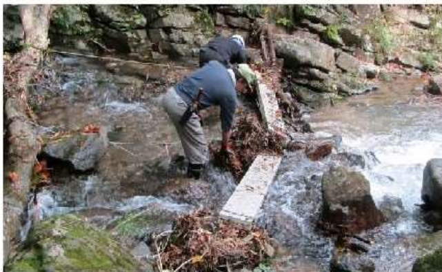
荒竜岩橋、作業前、流木・落葉が詰まっている
