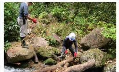
八幡滝上橋、流されていた
