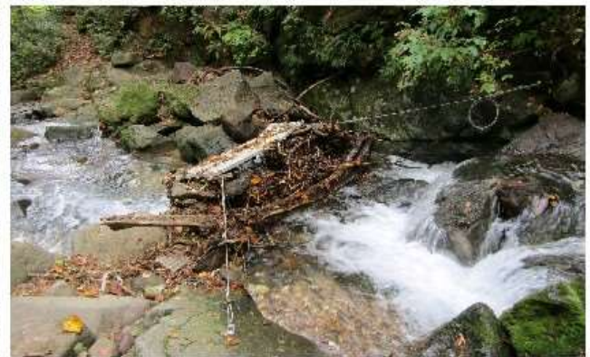
天狗岩上橋、作業前、落葉詰まっている
