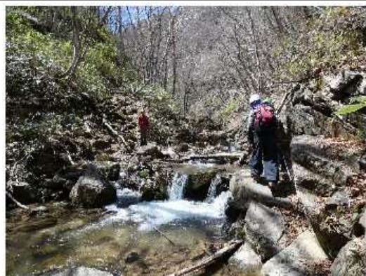
落橋している、⑤荒竜岩橋
