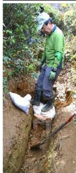
抉れ箇所に土嚢袋
