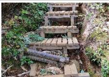
階段破壊状況
